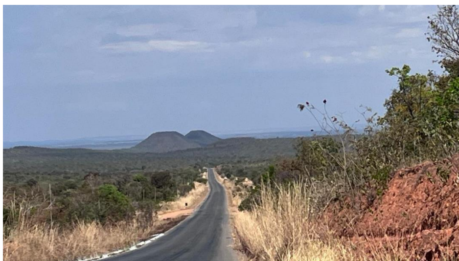
Figura 4. Baixada na rodovia GO-030 com risco de contaminação do Córrego.
